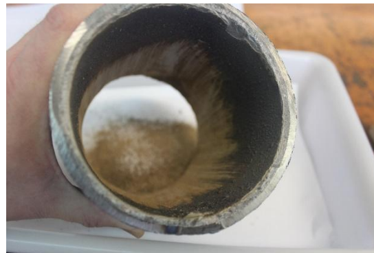
Incrustaciones parcialmente separadas
